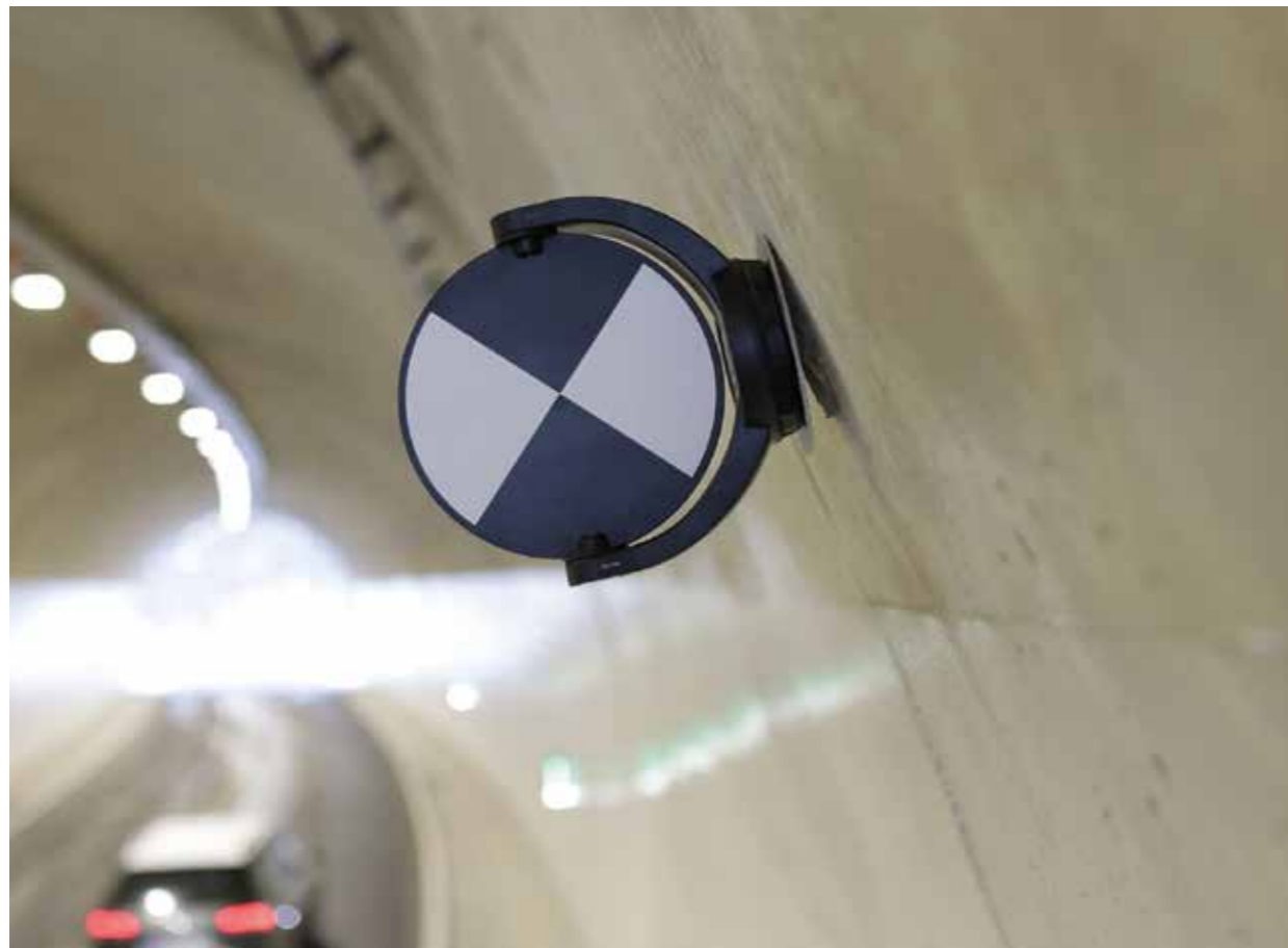
Laserscanner-Marke RSL422M im Tunnel
